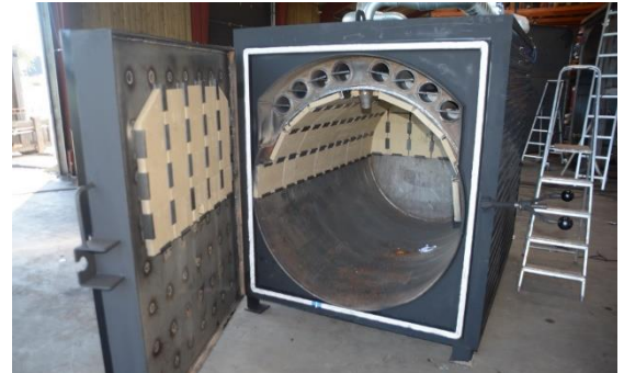
Foto 2. Kig ind i et halmfyr til minibigballer. De lyse plader for oven i kedlen er varmeisolerende kakler, som skal få forbrændingstemperaturen op, sådan at alle røggasser kan blive udbrændte. Mangler der ret mange varmeisolerende kakler, får kedlen en dårligere nyttevirkning, og risikoen for syrekondens i kedlen stiger
