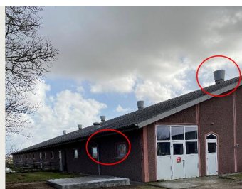
Emissionen måles i hvert afkast (loftudsugning) i stalden. Luften ind i stalden sker gennem ventiler placeret i væggene (over og ved siden af vinduerne).
