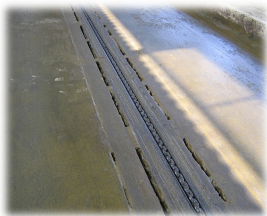
Figur 3. Rengjort gulv, men pas på udtørring.
