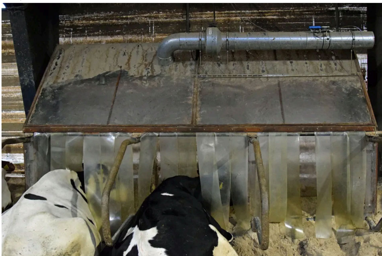
Det har været nødvendigt at skifte nogle lameller, men slitage var forventelig. Foto: Peter W. Mogensen
