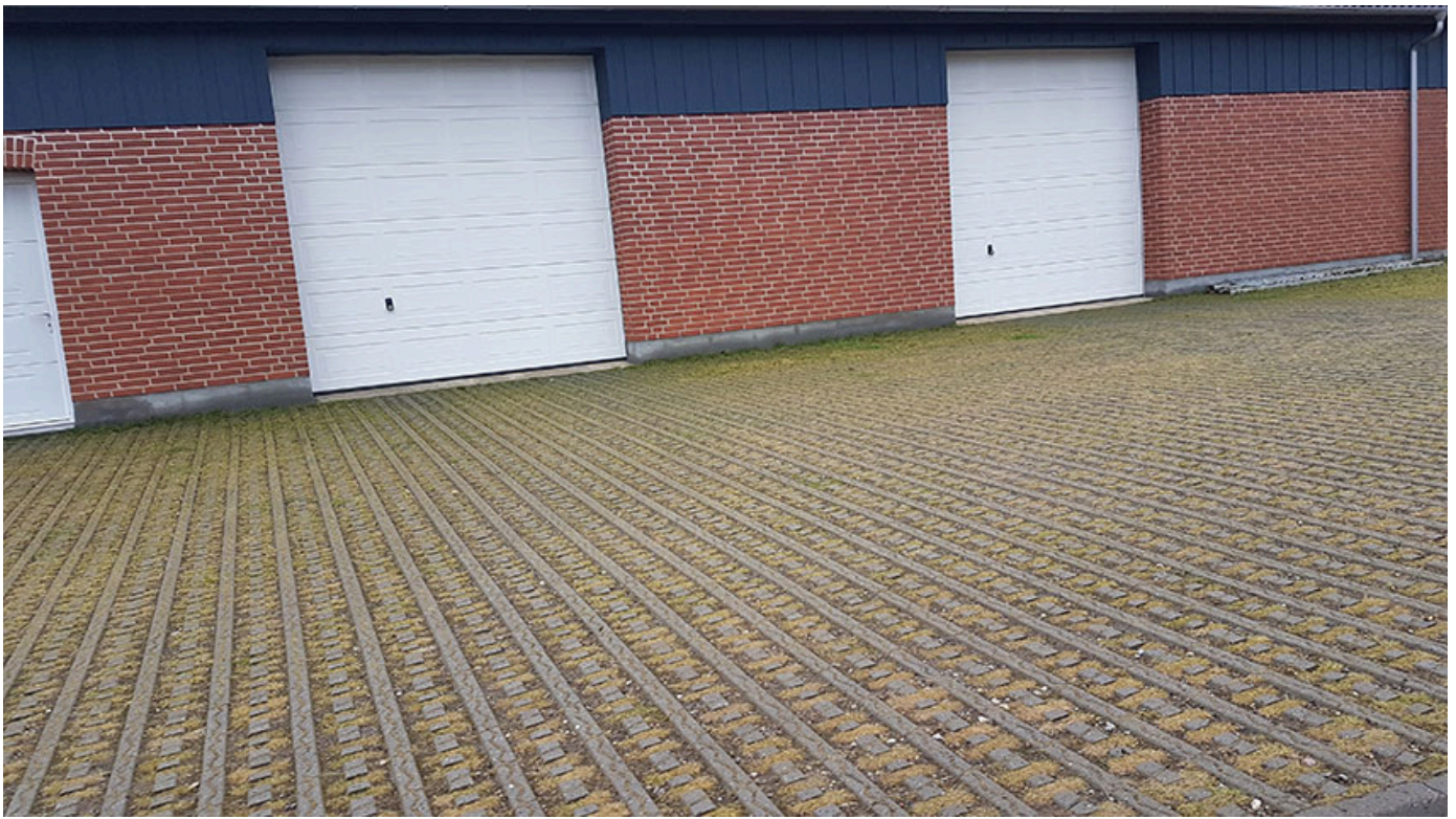
Billede 2. Eksempel på græsarmeringsfliser foran en lade. Det sikrer, at der stadig kan færdes med maskiner, mens græsset kan slåes efter behov. Foto: Carsten Fabricius, SEGES Innovation.
