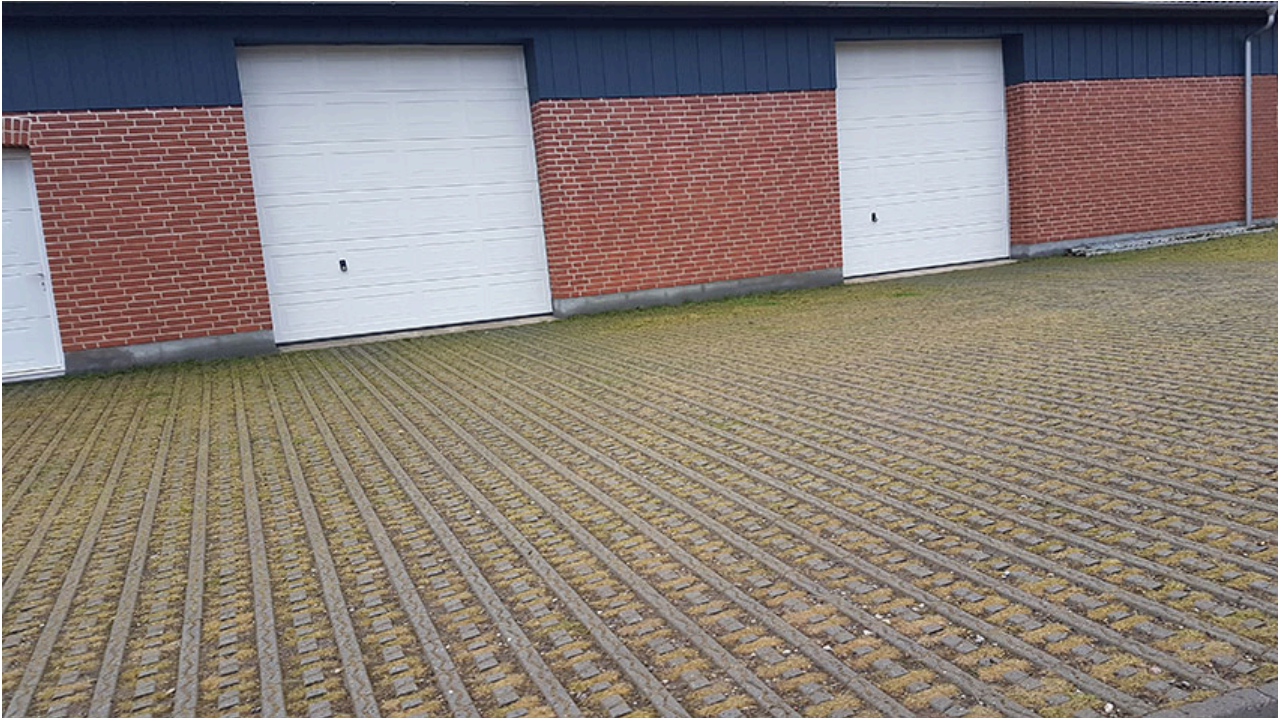
Billede 5. Eksempel på græsarmeringsfliser foran en lade. Det sikrer, at der stadig kan færdes med maskiner, mens græsset kan slås efter behov. Foto: Carsten Fabricius, SEGES Innovation.
