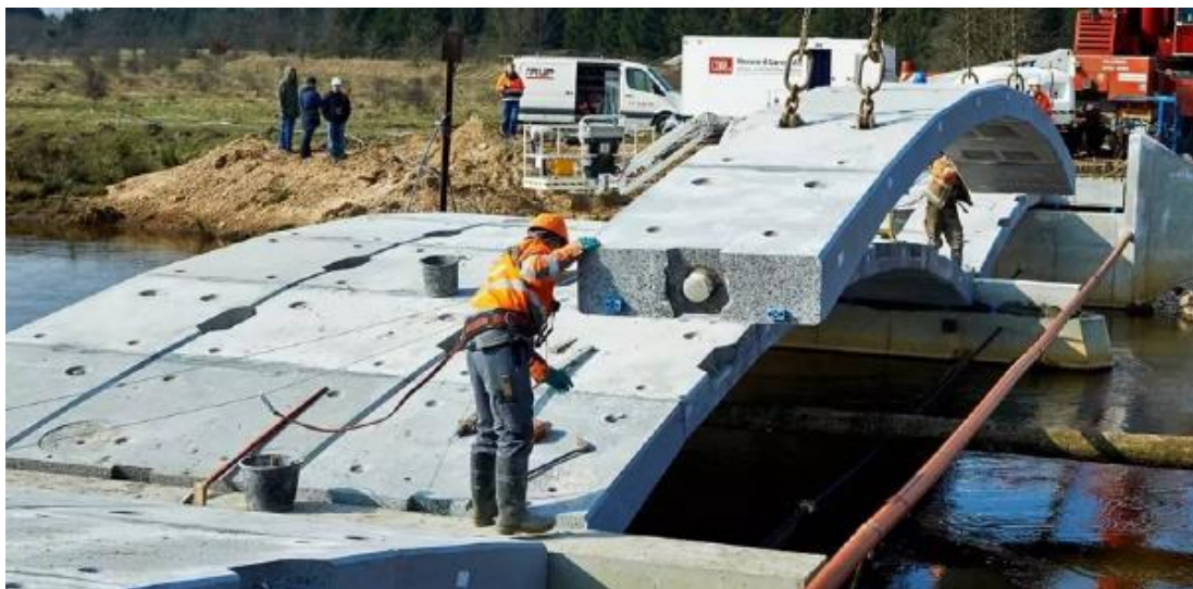
Figur 5: Øverst: Principskitse set fra siden af kabel, der løber igennem flere flade betonelementer med skrå ender. Nederst: Teknologien i brug ved bro over å i Jylland. Opspændingen af kablet ses i enden af det sidste element.
