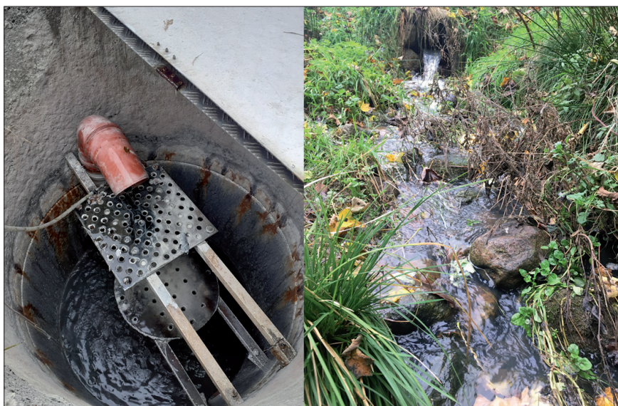
Figur 4. Iltningstrapper ved hhv. filtermatriceanlægget ved Skovlyvej (tv), og minivådområdet Jordrup (th), som viser et typisk eksempel på hvordan iltningstrapper i minivådområder er konstrueret.
