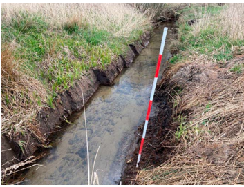
Billede 1: Maskinel oprensning af vandløb, der tidligere har været vedligeholdt gennem manuel grødeskæring. Oprensningen har karakter af regulering, da vandløbets skikkelse er ændret.
