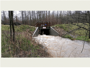
Billede 7: Rathlousdaldæmningen i fuld aktion. Her ses hvordan vandet presses gennem det begrænsede gennemstrømningsprofil på nedstrøms side af løsningen, februar 2022. Foto: Odder Kommune.
