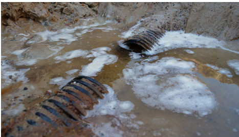
Billede 8: Nøgenrør + filtergrus med L-plov, fiberdug under. Her blev det observeret at filtergruset var trængt ind i drænrøret, og at det derfor har været for fint i størrelsen. Dog ingen tegn på indtrængning af finsand eller okker. Foto: Martin Stoltenberg Hansen, SEGES Innovation.
