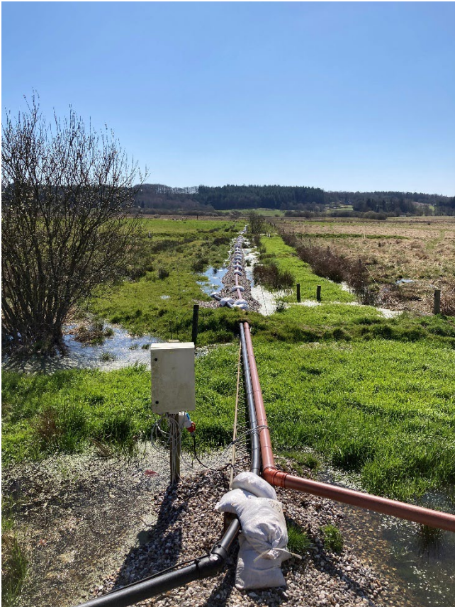
Figur 3: Vandføringsløsning ved filteranlæg i Vejrumbro. Vandet hentes fra vandindvindingsbassin tæt ved åen og føres op til anlægget via det sort rør. Dette gøres for rense mest mulig vand fra hele lavbundsarealet. Vandet føres tilbage til åen via de røde rør, for ikke at udlede rensset vand på engen, da dette kan have en indvirkning på andre af AU forsøge i området.
