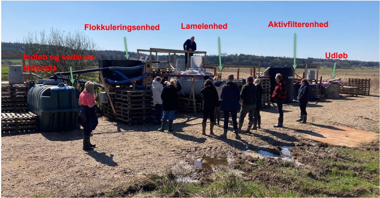
Figur 1: Filteranlæg ved Vejrumbro
