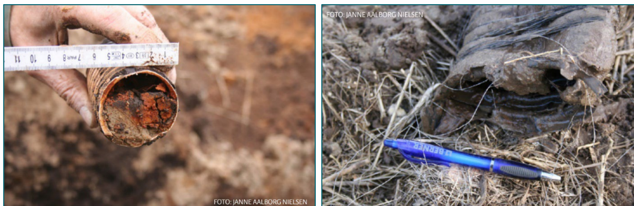
Figur 25. Drænrør kan være defekte, fordi de er blevet tilstoppet af okker (venstre) eller er blevet klemte (højre). (Fotos: Janne Aalborg Nielsen, SEGES Innovation).
