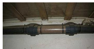
Der skal være monteret gennemsigtige stykker på rørstrengen før og efter sidste ventil, så det kan kontrolleres, om der er foder eller skubbemedie i rørstrengen.
