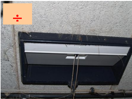
Pkt. 3 Loftventilen lukker ikke tæt
