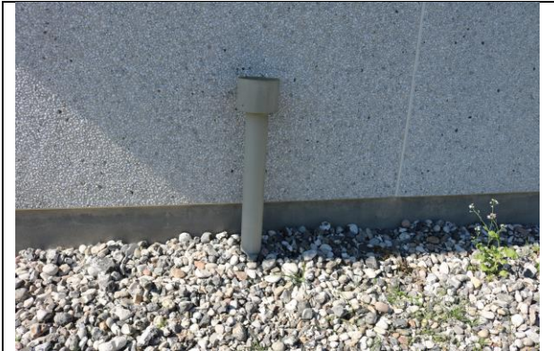
Figur 2. Udvendig udluftning i bagenden af rørstrengen med påmonteret hætte.
