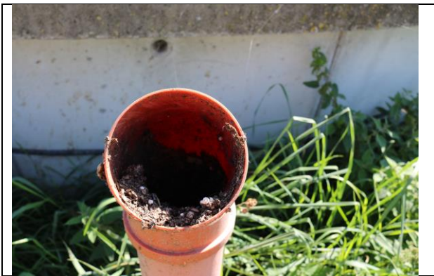
Figur 3. Udluftning før fortank, som trængte til rengøring.
