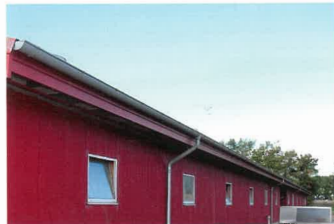
25 år gammel dansk Ø-stald beklædt med de oprindelige træplader og en sokkelhøjde på 20 cm samt tagrender og nedløbs-rør, der har kunnet hindre, at underkanten af vægbeklædningen blev fugtig.
