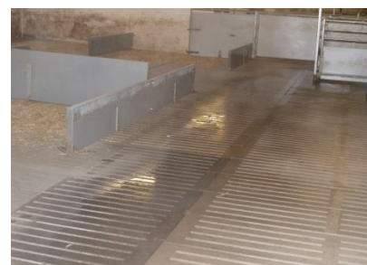
Lad overbrusningsanlægget køre inden søerne indsættes, så gødearealet er markeret.
