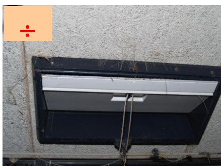
Pkt. 3. Loftventilen lukker ikke tæt.
