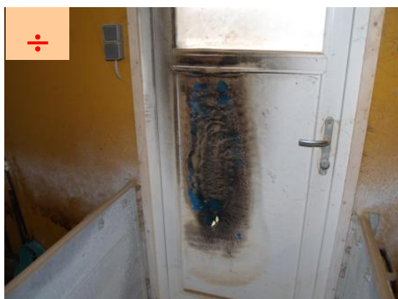
Varmekanon for tæt på dør.
