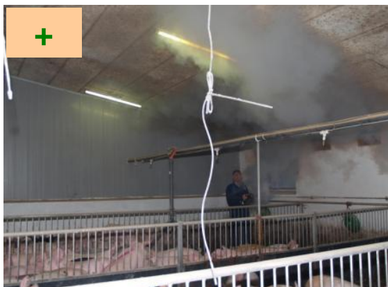
Pkt. 1. Kontrol af luftbevægelser via røg.
