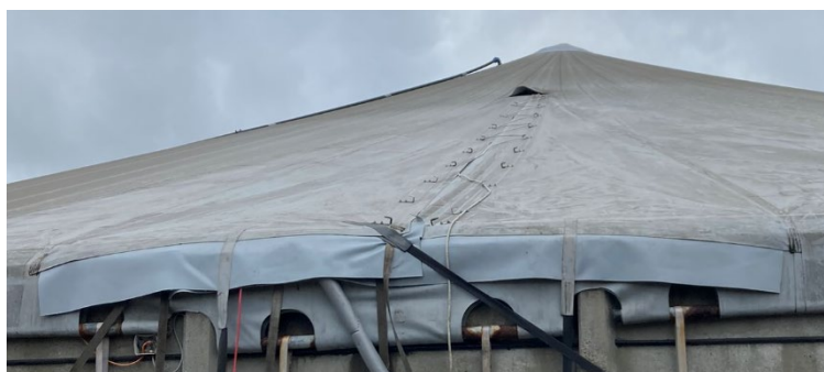
Figur 3: Billede af forlængelse af trekantsluger for at minimere metan udslip langs gylletankens kant (Tank A).
