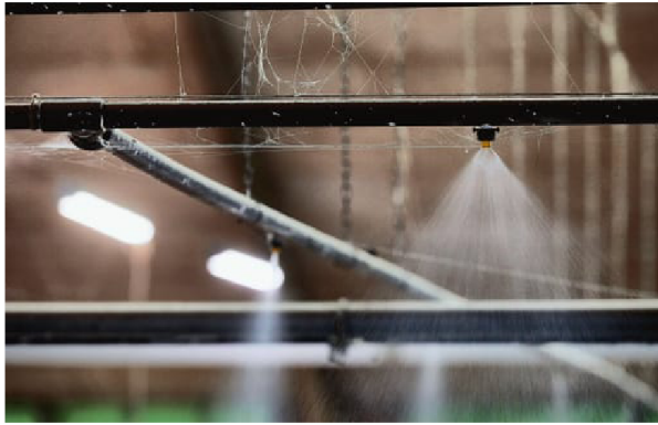
Dyserne skal være afkalkede for at opnå et ordentligt spredsbillede og effekt af overbrusningen.
