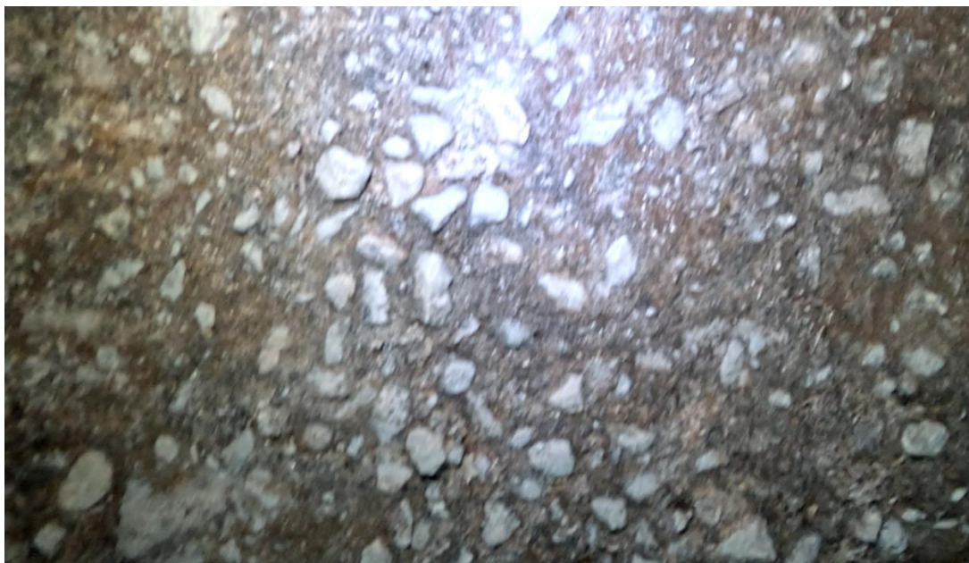
Figur 1. Eksempel på forvitringsskade grad 3 i beholder nr. 8.
