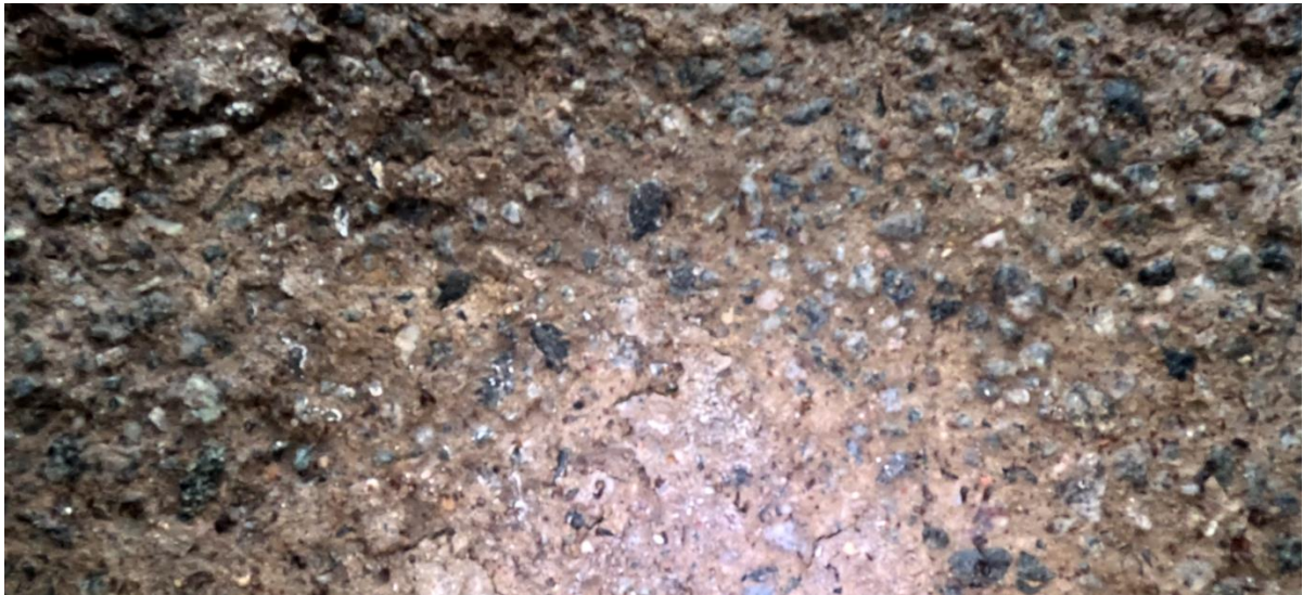
Figur 3. Eksempel på forvitringsskade grad 2 i beholder nr. 10.
