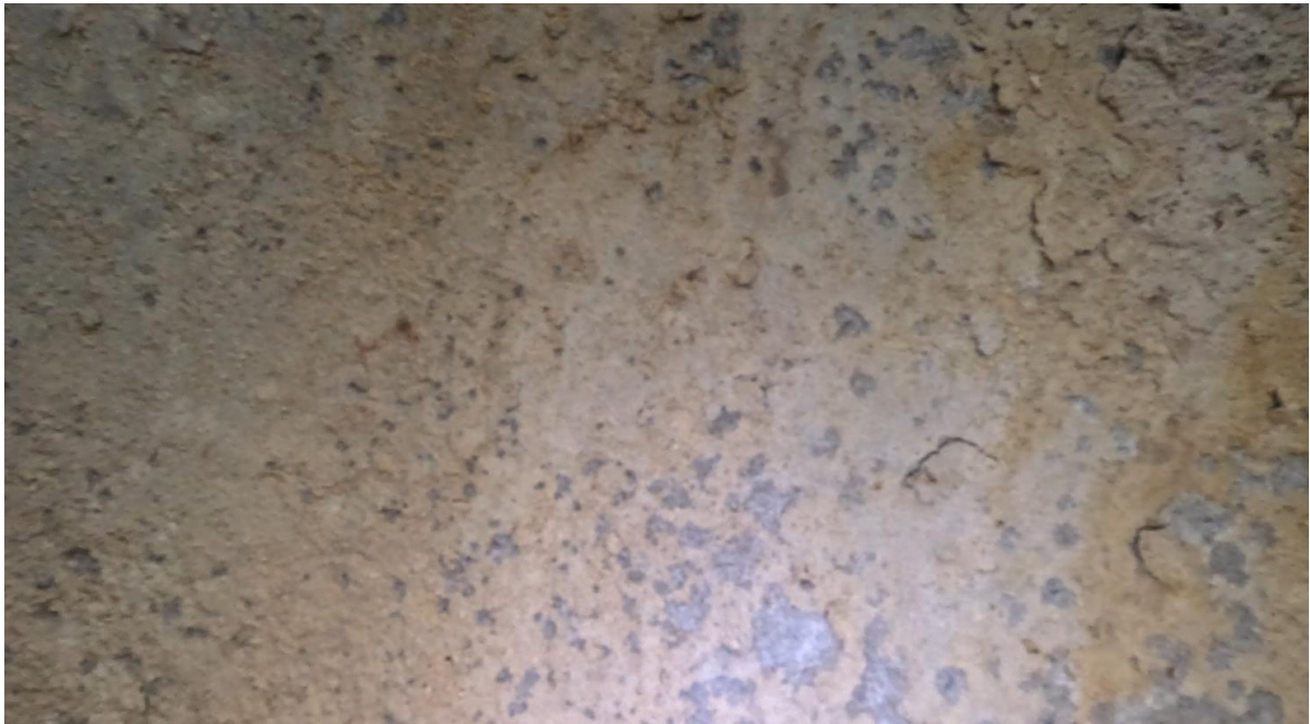
Figur 4. Eksempel på forvitringsskade grad 1 i beholder nr. 6.
