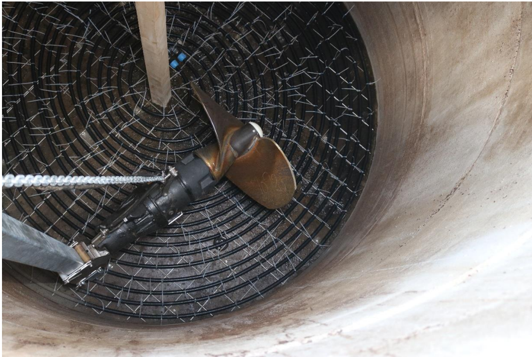
Figur 2. Omrører monteret i tank med køling. De udlagte køleslanger ses i bunden af tanken.
